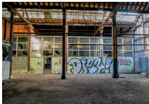
A sa reprise le bâtiment était relativement dégradé
